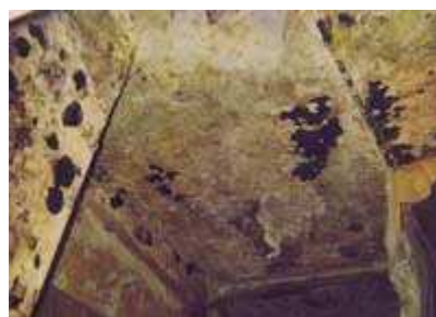
Bild 1.2.: Wasserleitungsschaden wurde nicht getrocknet
