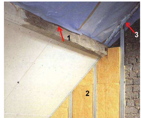
Bild 3.2.5.: In diesem Bild wird eine Vorsatzwand als Metallständerwand CW 50/40 mit 40 mm Mineralwolle gezeigt. Als Wohnungstrennwand wird es kaum Feuchtigkeitsprobleme geben, abgesehen von der fugendichten (?) Anbindung der blauen Dampfbremse. Bei einer 24er außen liegenden Giebelwand gibt es eine Wärmebrücke. Das Gleiche sollte auch bei einer Innenwand beachtet werden, wenn die andere Dachseite ein ungedämmter Boden ist. (2) Fuge bei der Dampfbremse (1), unzureichende Befestigung des Ständers an der Konstruktion (3) (/9/ S. 45)
